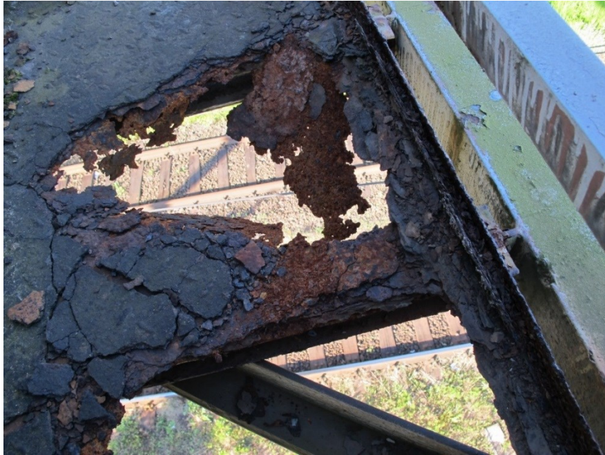
Rysunek 5. Korozja blach podestu suwnicy.
